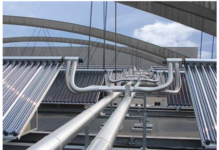
Verrohrung der Solarkollektoren auf dem Messedach
