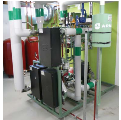
Einspeisestation der schwedischen Firma Armatec
