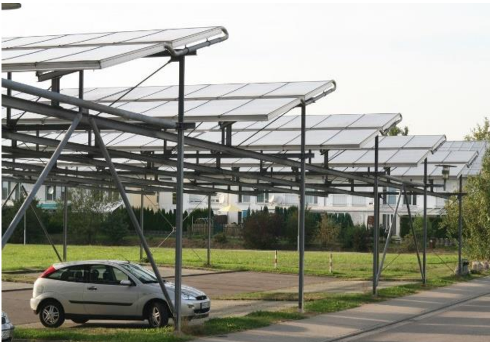
Abbildung 2-25: Kollektoranlage als Parkplatzüberdachung in Neckarsulm (Foto: Solites)
