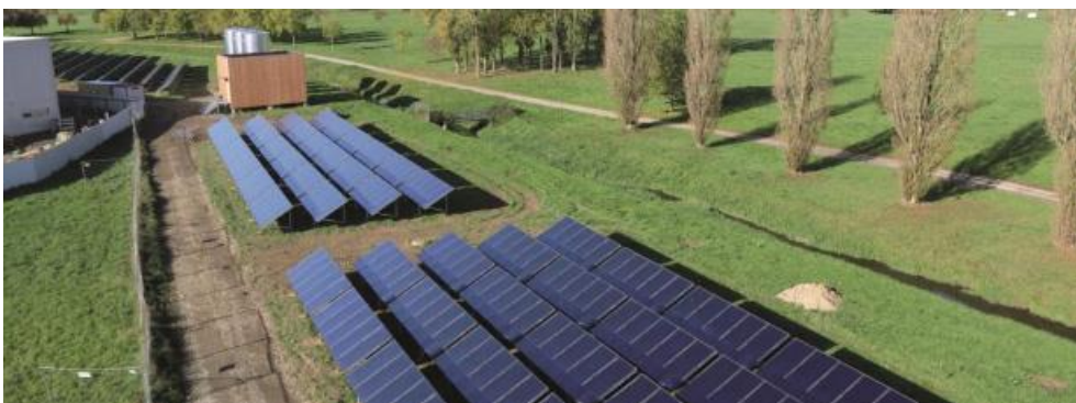
Abbildung 2-21: Solaranlage auf einer Überflutungsfläche in Châteaubriant
