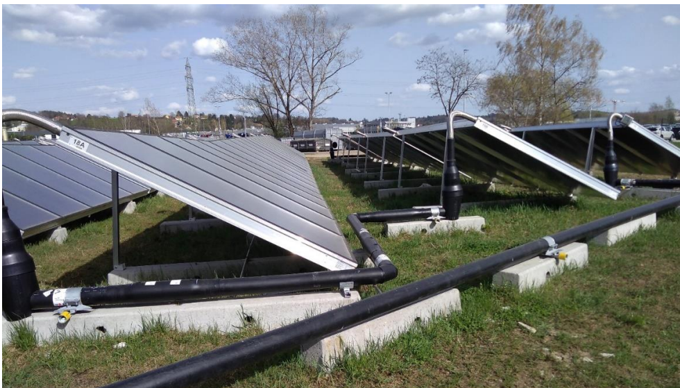
Abbildung 2-16: Freiflächen-Solaranlage in Graz (Foto: Hamburg Institut)
