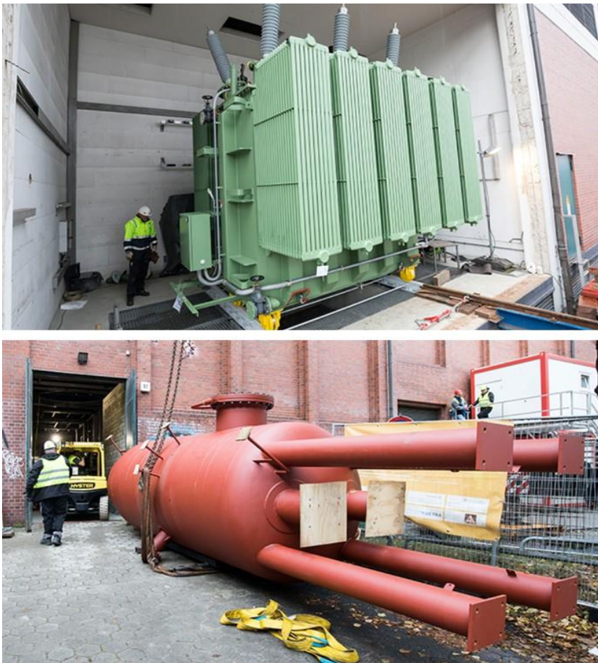
Abbildung 23: Elektroheizkessel „Karoline“ – eine 45-MW-PtH-Anlage im Hamburger Karolinenviertel wird in ein Umspannwerk eingebaut (unten). Die Anlage liefert als Teil des Projektes NEW 4.0 einen Beitrag zur norddeutschen Energiewende. (Quelle: Vattenfall 2018)
