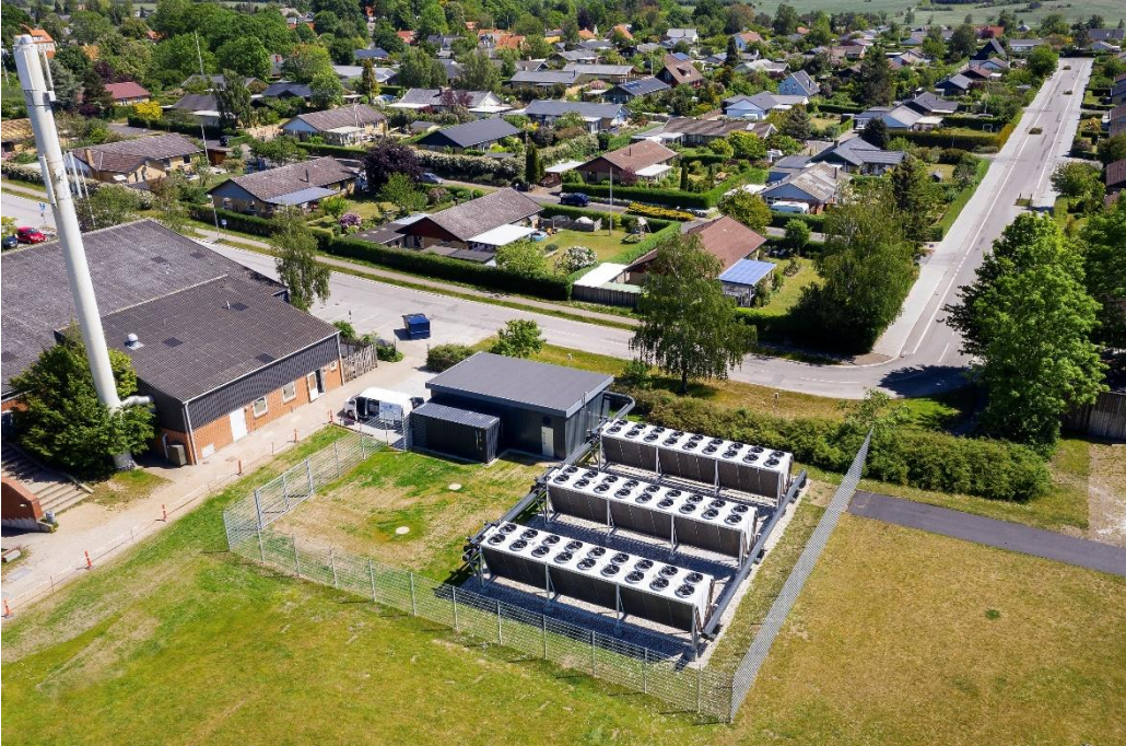
Abbildung 16: 1-MW-Luftwärmepumpe mit Wärmequelle in Slagslund, Dänemark (Urheber: PlanEnergi)
